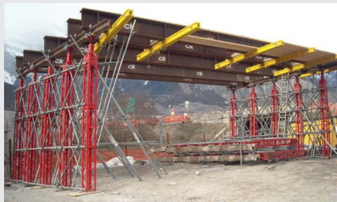
Étagage réalisé à l'aide de poutrelles Peiner et de profilés en acier HEB 600
